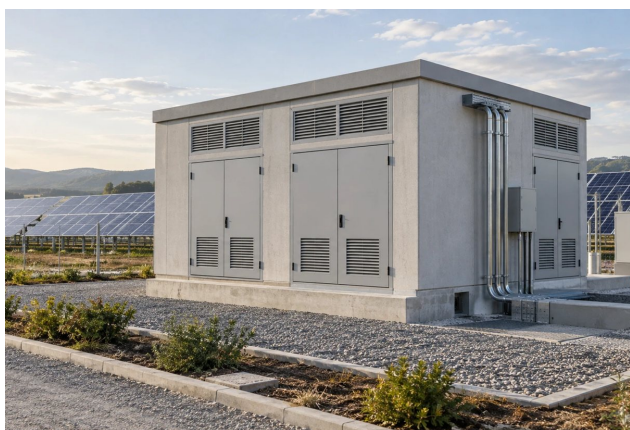
DISTRIBUCIÓN / CENTROS DE TRANSFORMACIÓN
