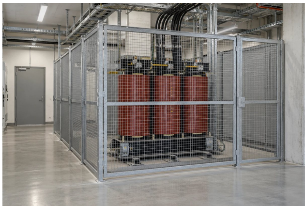
TRANSFORMACIÓN / INSTALACIONES INTERIORES
